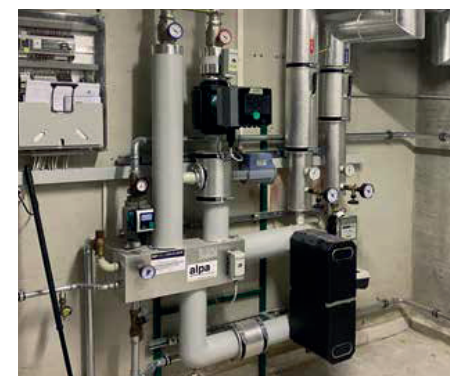
Echangeur thermique dans un bâtiment relié au Thermorezo
